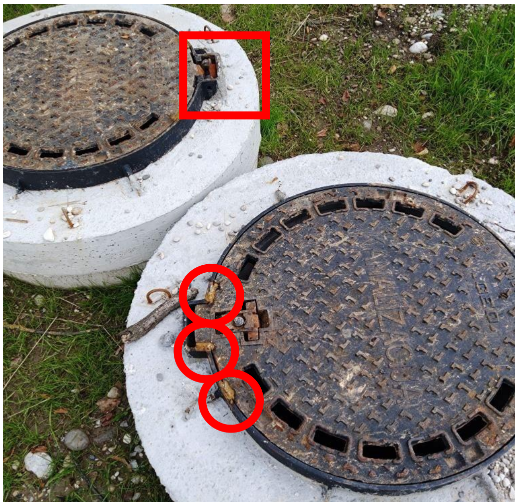
Slika 12. Napačna višina jaškov, polomljeni pokrovi, zavarjeni jaški
