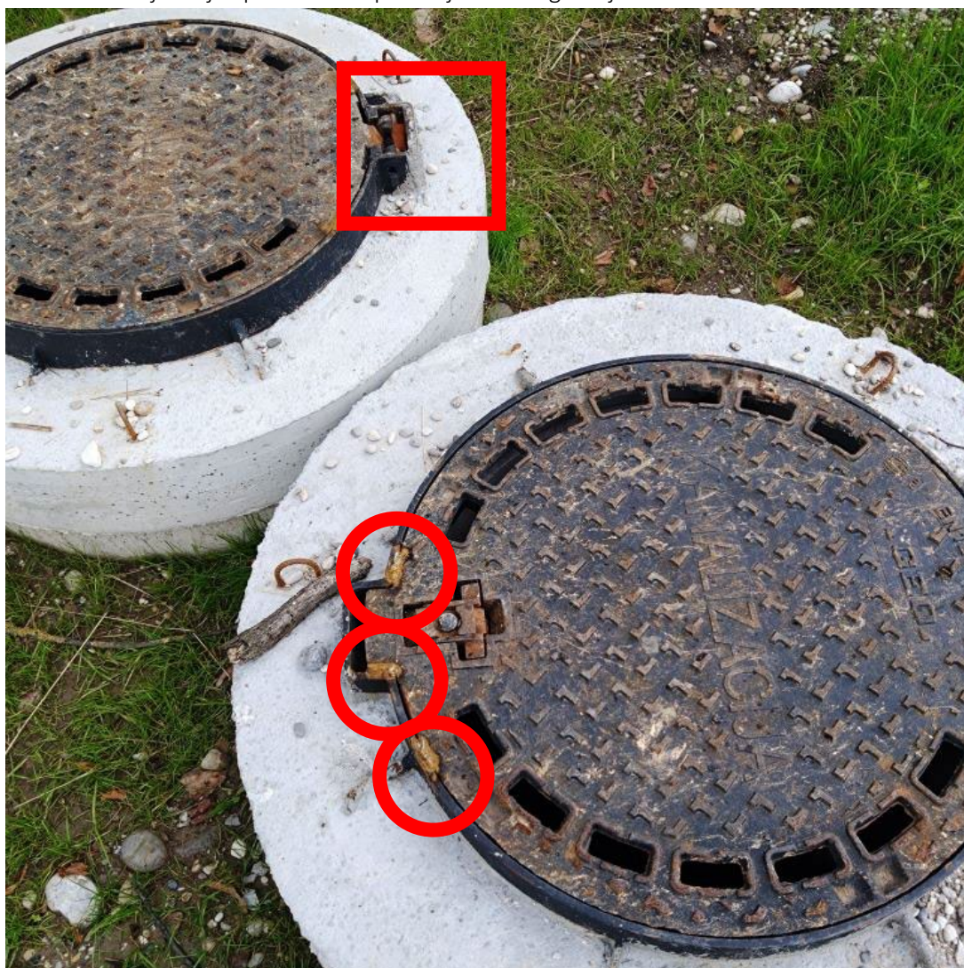
Slika 12. Napačna višina jaškov, polomljeni pokrovi, zavarjeni jaški
